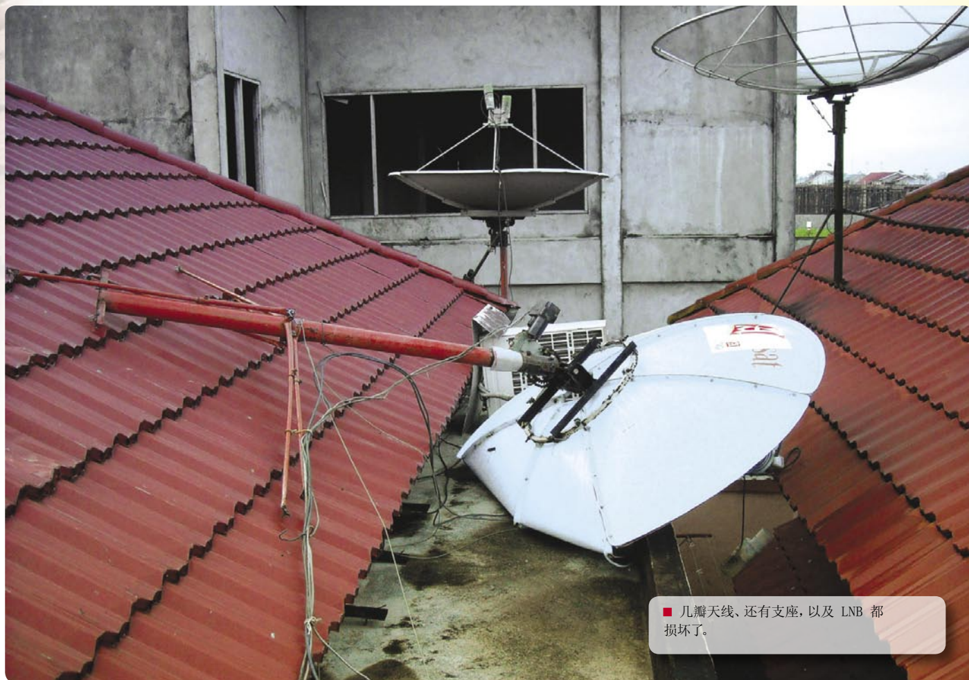
■ 之后: 多么令人惋惜, 1.8 米的天线被大风吹倒了。
